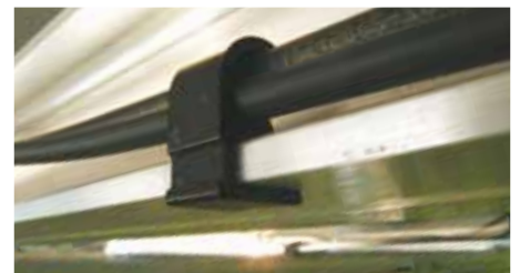
Kabelführung bzw. Kabelkanal
