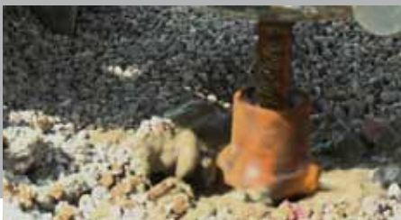
Austritt von Zementmörtel durch Kreuzbohrkrone
